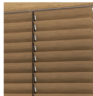
Ikke korrekt lukket
